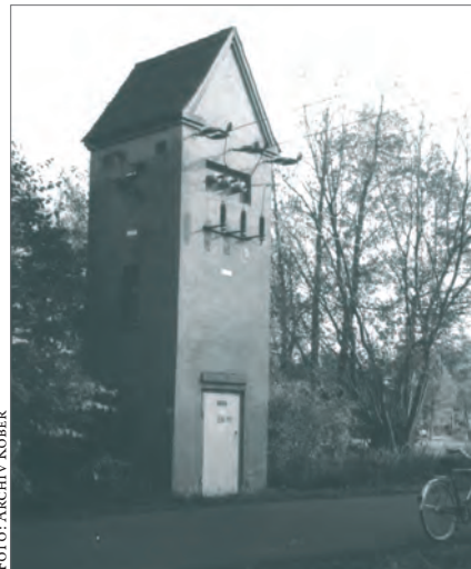
Die Trafostation „Wildbahn“, wie sie 2006 noch die nahegelegenen Gehöfte versorgt
